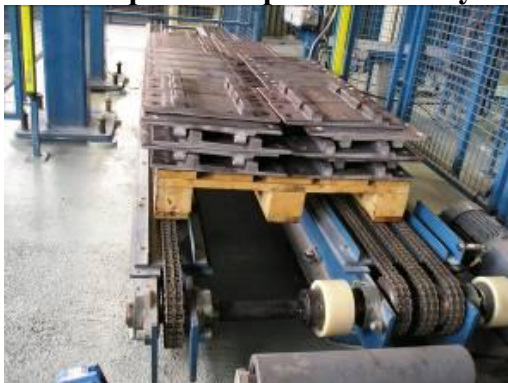
Detail dopravníku palet s obrobky
